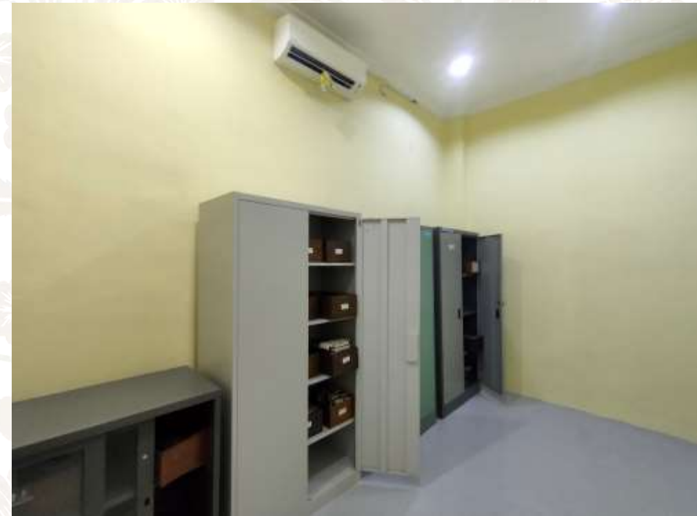
AC pada Ruang Penyimpanan Arsip Media Baru
